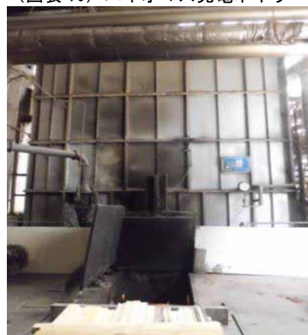
(図表10) バイオマス発電ボイラー
