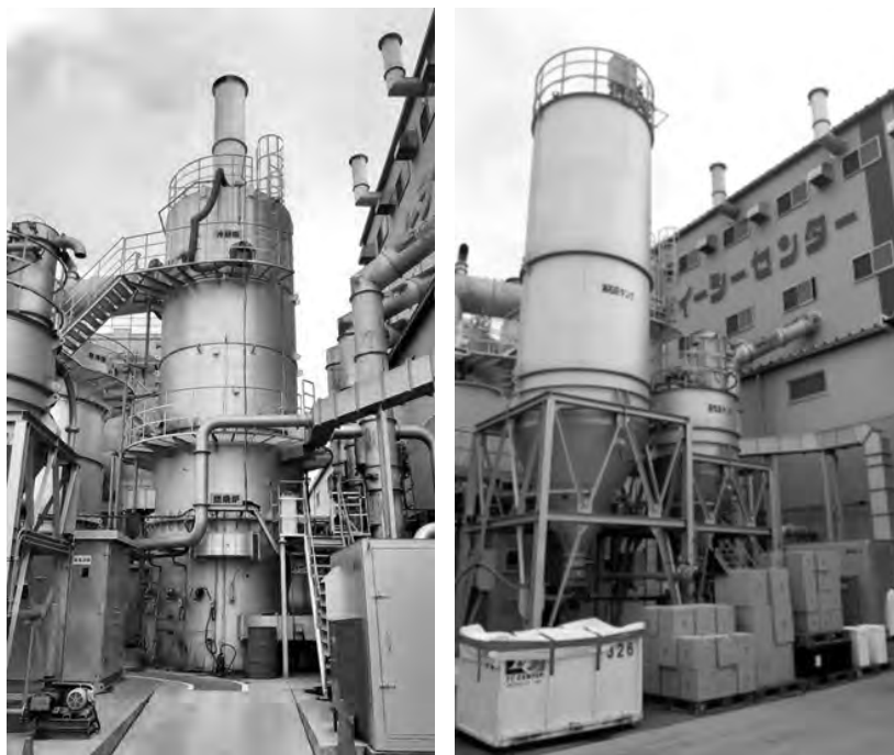
図表10 バイナリー発電施設（乾溜ガス化炉発電施設）
