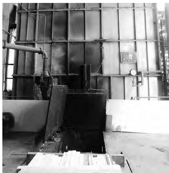
図表10 バイオマス発電ボイラー
