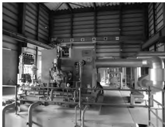
図表6 バイオマスボイラー
