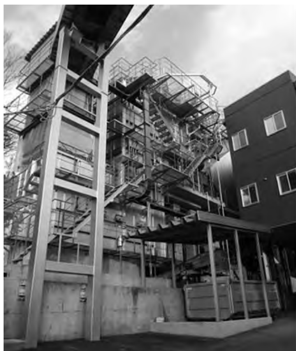
図表12 バイオマスボイラー
