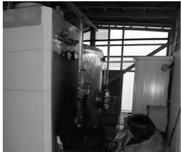
図表9 薪ボイラー
