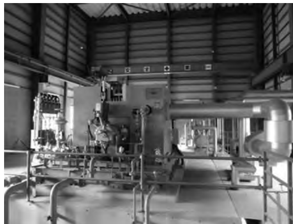
図表6 バイオマスボイラー
