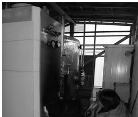
図表9 薪ボイラー
