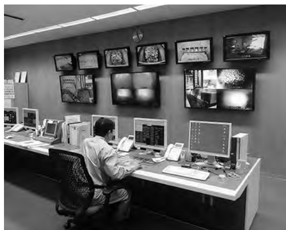
図表14 当センターの中央制御室
