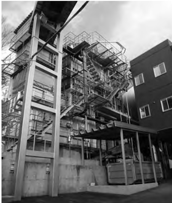
図表12 バイオマスボイラー
