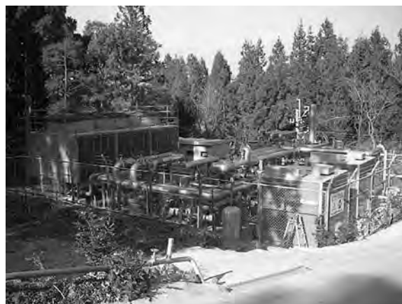
図表10 五湯苑地熱発電所プラント(上)と遠隔モニタリング(下)
