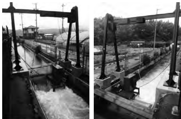
図表2 立梅用水に設置した小水力発電機「彦電」
