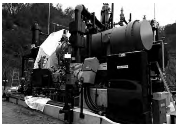
図表8 土湯温泉第16号源泉バイナリー地熱発電所
