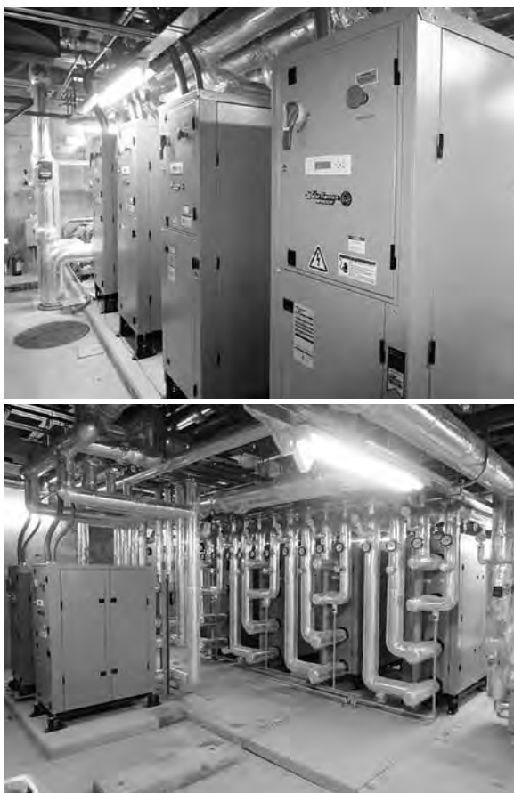
図表13 地中熱利用ヒートポンプ(上:表側、下:裏側)
