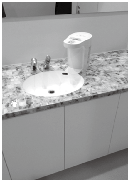
図表7 女性用トイレの洗面台
