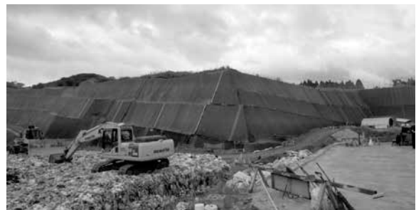
図表12 ゴミの埋立処分場の状況
