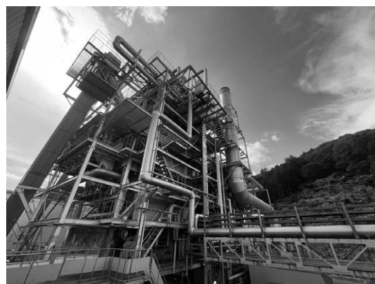
図表17 発電所設備の外観
