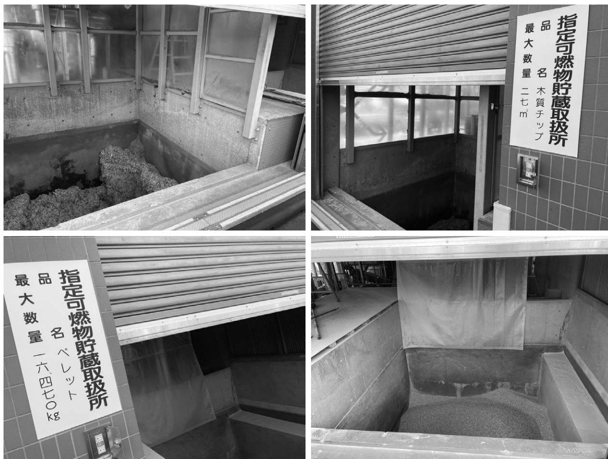
図表5 市役所庁舎脇の燃料貯蔵タンク
