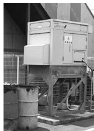
図表13 LPガス発電機
