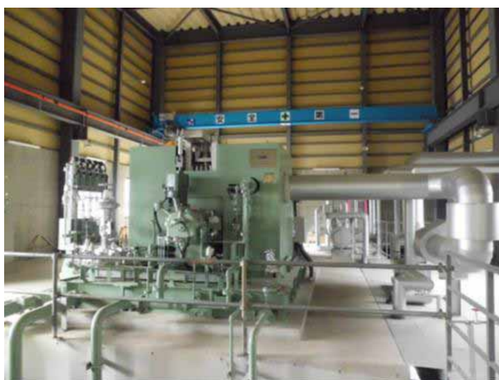
（図表6）バイオマスボイラー
