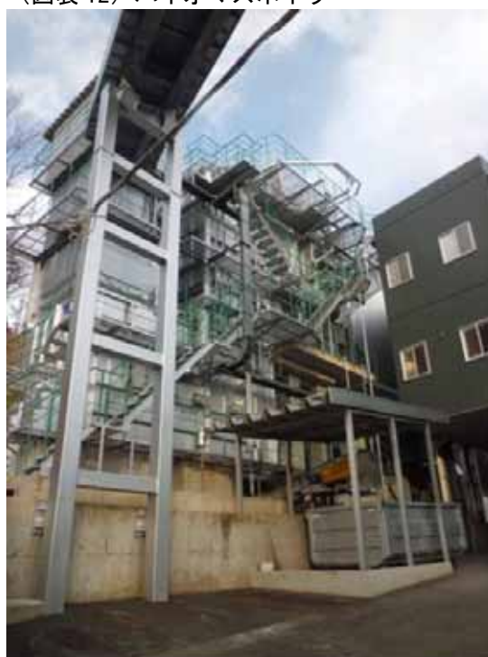
（図表 12）バイオマスボイラー
