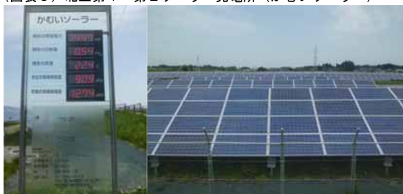
(図表5) 北上第1・第2ソーラー発電所(かむいソーラー)
