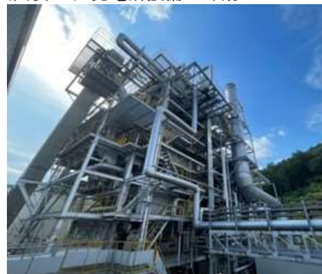
（図表17）発電所設備の外観
