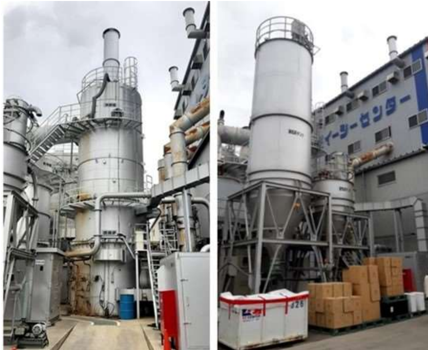
(図表 10) バイナリー発電施設 (乾溜ガス化炉発電施設)
