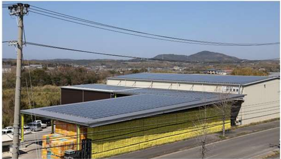
（図表5）巨大冷蔵庫の屋根に設置された太陽光発電パネル
